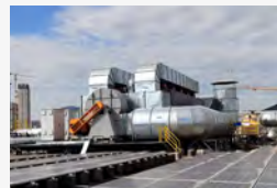
废气治理系统升级改造
